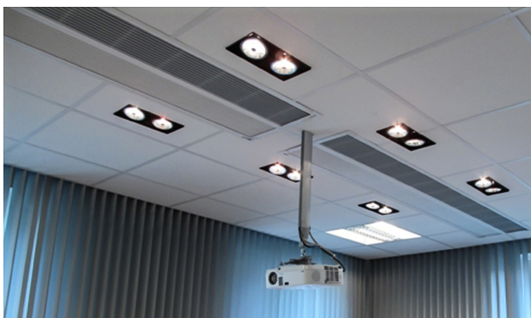
▲ ESEMPIO: due travi fredde Mini montate in parallelo
