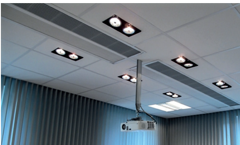
▲ BEISPIEL: Zwei parallel montierte Mini Kühlbalken
